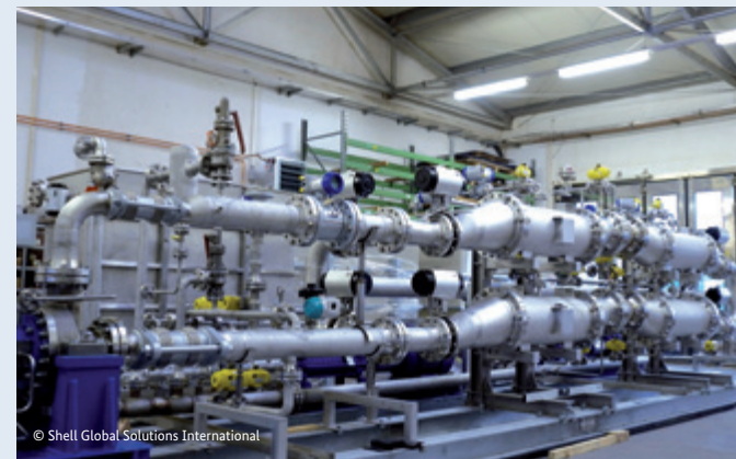
Nanofiltrationsmembrananlage zur Entsalzung ölhaltiger Abwässer
