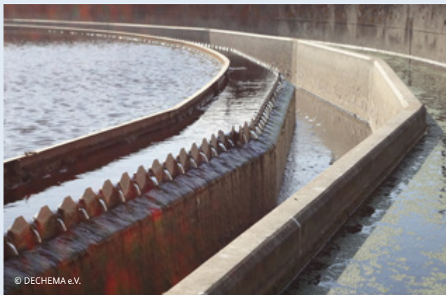
Nachklärbecken einer Abwasserbehandlungsanlage
